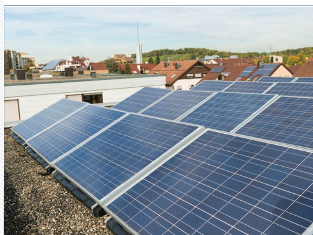
Figura 3: Paneles solares sobre una cubierta plana (fuente: IVPU)
