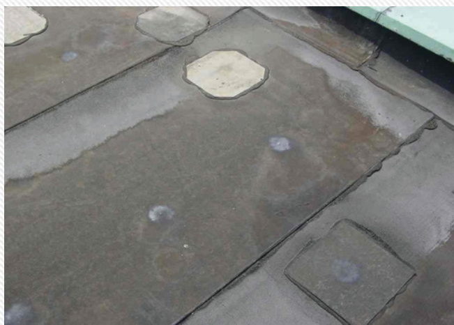
Figura 1: ejemplo de cubierta dañada
